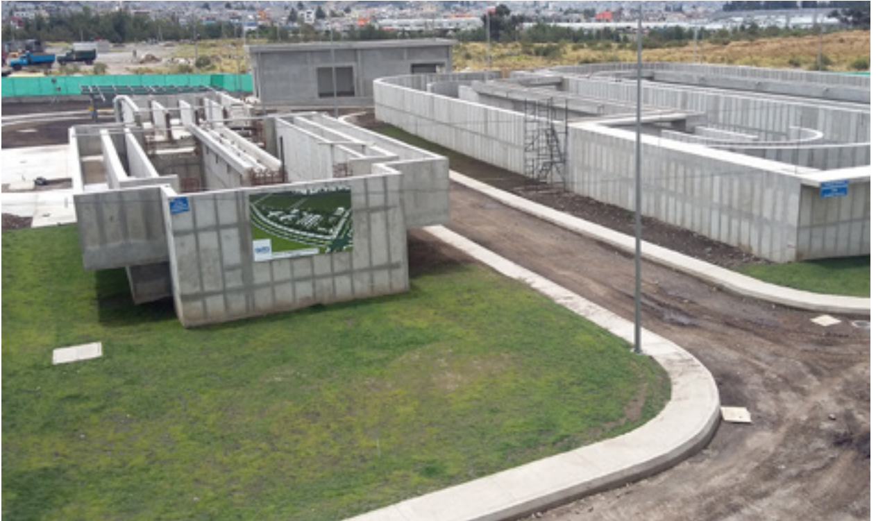
QUINTO (ECUADOR) - IMPIANTI DI TRATTAMENTO DELLE ACQUE REFLUE DI QUINTO (2012 - 2014)
