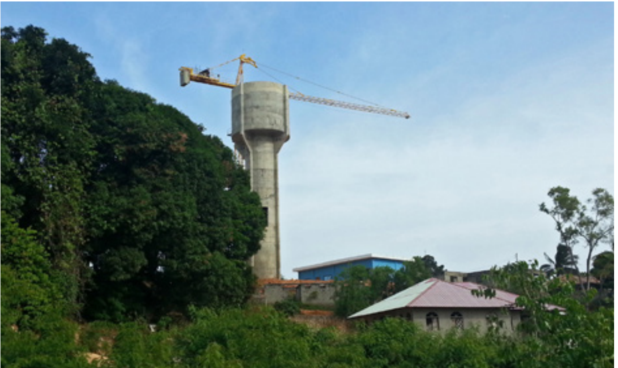
PEMBA (TANZANIA) - APPROVVIGGIAMENTO IDRICO URBANO NELL'ISOLA DI PEMBA (2011 - 2015)
