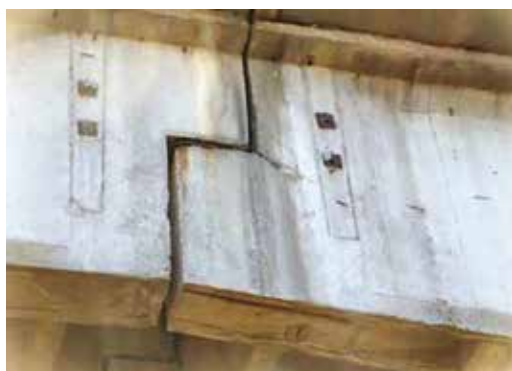
4. Lo stato fessurativo delle selle Gerber
